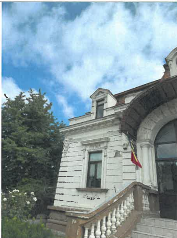
Fig. 1 Degradari tencuieli exterioare
