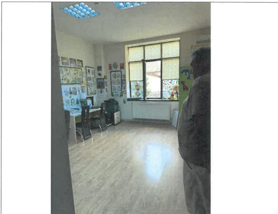
Fig. 7 – Parter- se poate observa stalpisorul de beton inserat in anul 2009
