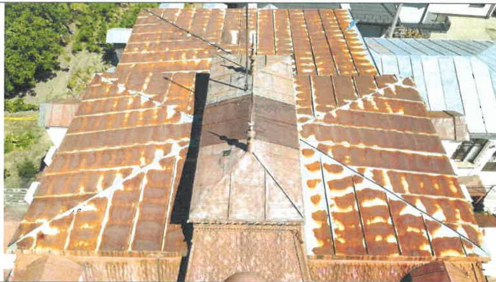
Fig. 5 – Degradari ale invelitorii din tabla
